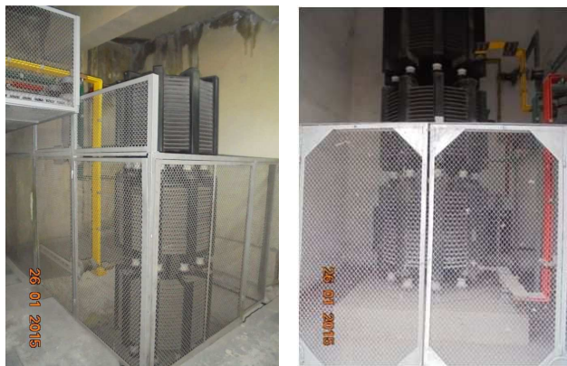
Фиг.3. Общ вид на токоограничаващи реактори Ср.Н., използвани във вътрешнозаводска подстанция
